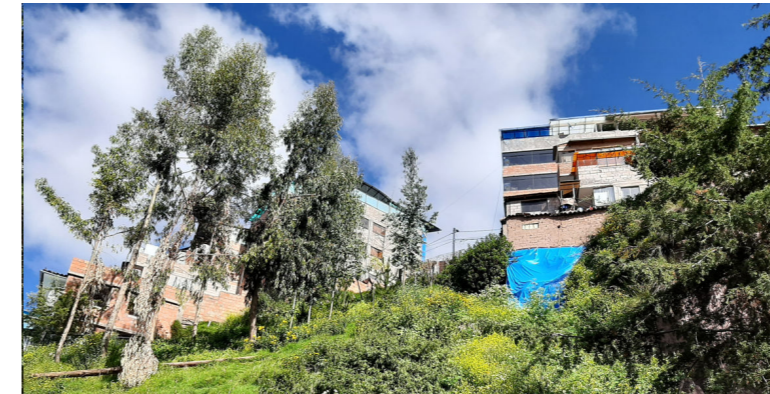
EDIFICACIÓN CON RIESGO DE COLAPSO, UBICADA EN LA MANZANA H1.
